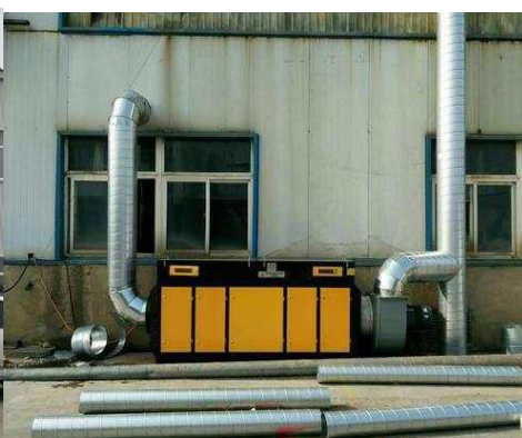
废气处理装置
